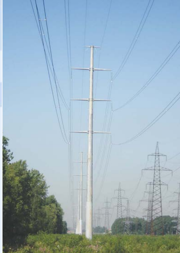
ВЛ 330 кВ «Восточная – Волхов-Северная». Опоры МПГ 330-2т.
