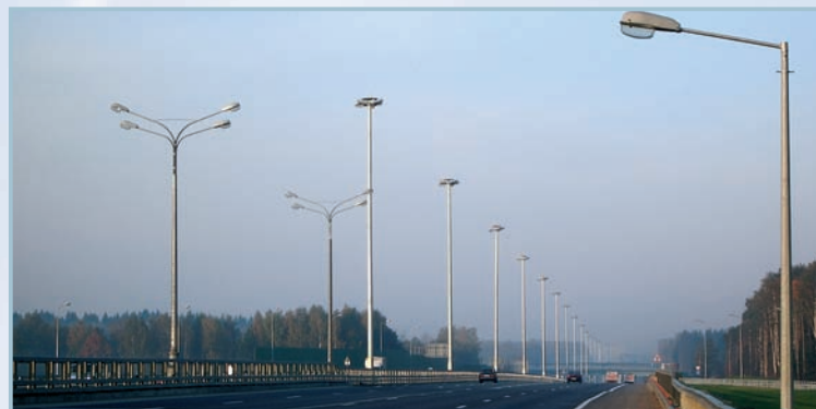
Осветительные опоры (Киевское шоссе, Московская обл.)
